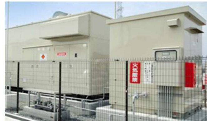
非常用発電機
