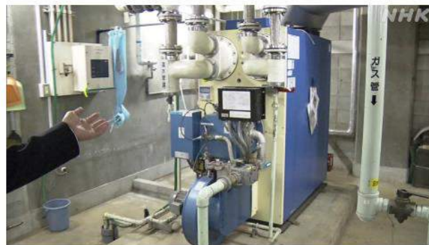
バックヤードにあるガスボイラー
